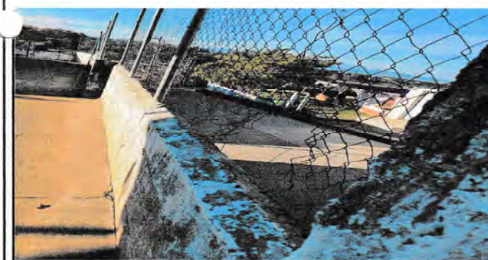
Foto 5: daños en muro perimetral, la malla esta rota, los niños sacan la cabeza para ver hacia parte de afuera y es un riesgo.
