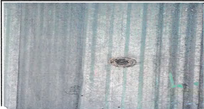
Foto1: láminas en mal estado,
